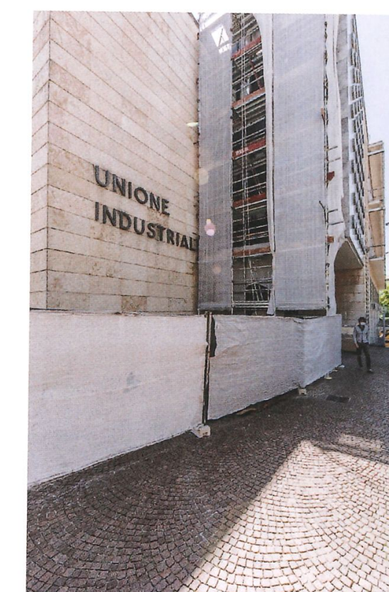
Vista dell'ingresso dell'edificio, tra via Fanti e via Vela, durante le opere di cantiere
